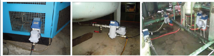
安裝於空氣桶與冷凍乾燥機
